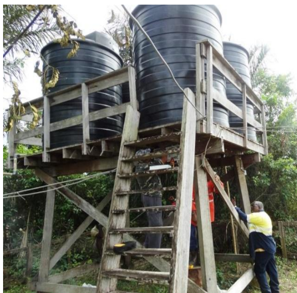
Deel waterleidingsysteem Langatabiki
